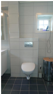
Vegghengt toalett mangler lekkasjesikring/hull i veggflis til sisterne under toalettskål.
