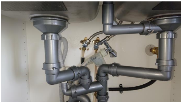
Vannstopp på vannledning var montert.
