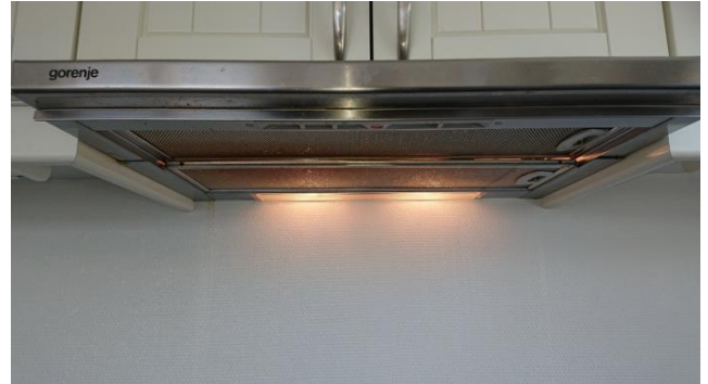
Det er montert en kjøkkenventilator med avtrekk ut.
