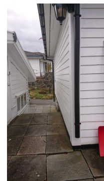
Tiltak med bortledning av vann fra nedløpsrør bør påregnes.
