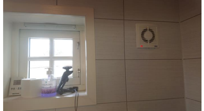
El.avtrekksventil i yttervegg.
