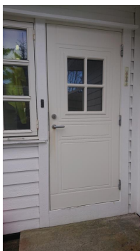
Overflatebehandling av ytterdør bør påregnes.
